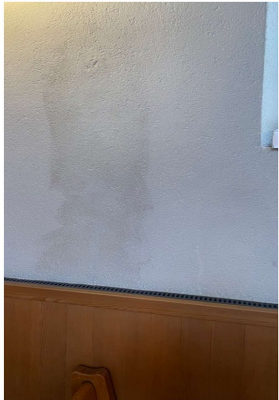
Verschmutzung an Aussenwand
